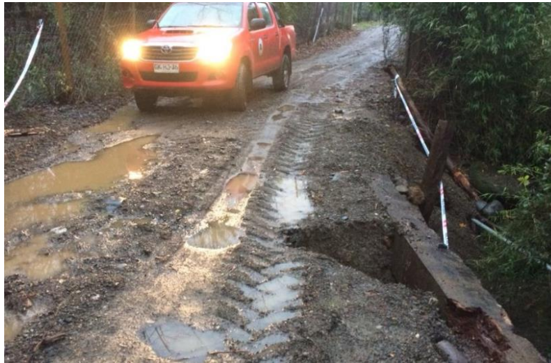
Imagen 22: Socavón en camino en el sector El Macal
